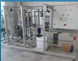
Obr. 1: Maloprovazní jednotka v AdMaS centru v Brně [foto J. Vespalec]
